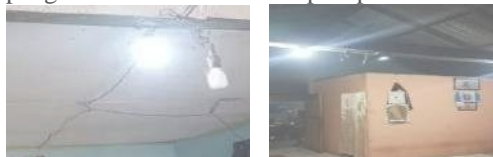
Gambar 4. Kondisi penerangan di malam hari sesudah instalasi instalasi sistem Solar sel.
