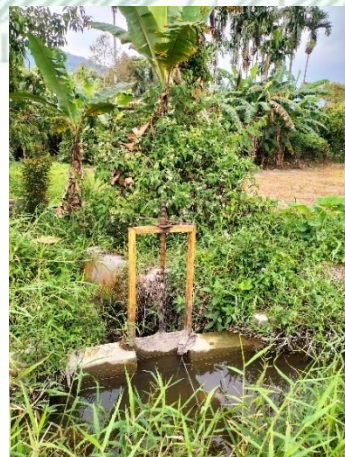
Gambar 5.5 Kondisi Bangunan pada Saluran Pembuang Sumber : Dokumentasi Peneliti (3 Mei 2024)
