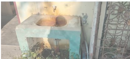
Gambar 2. Kondisi wastafel yang tidak terawat
