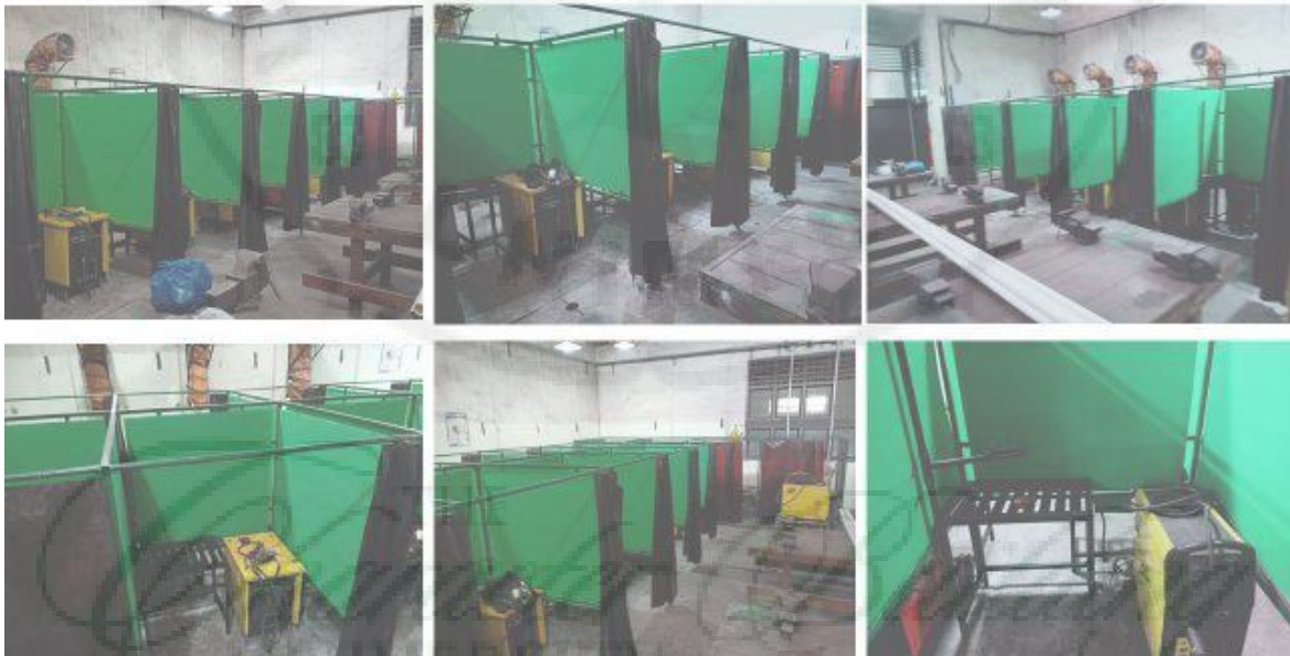
Gambar 4.2 Ruangan pengelasan sebanyak 16 unit yang sudah direnovasi secara total meliputi instalasi listrik, faktor keamanan, clemp, mesin las SMAW kapasitas 250 Ampere untuk pengelasan standar industri
