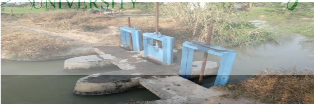
Gambar 16. Kondisi Pintu Air Yang Baru di Cat Desa Wonosari
