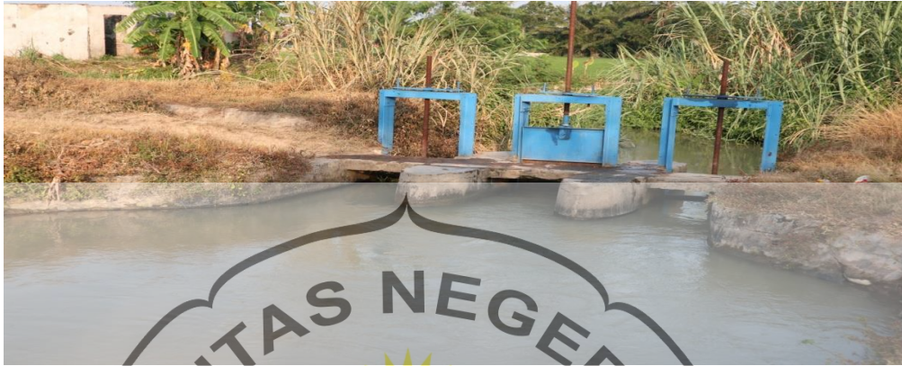
Gambar (a) kondisi bangunan irigasi di Desa Wonosari
