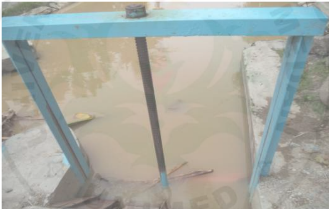
Gambar 9. Kondisi Jaringan Irigasi Primer di Desa C. Damai Tahun 2014
