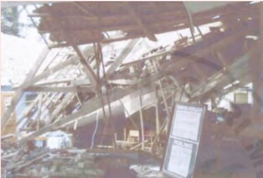
Salah satu SD dengan kondisi ruang kelas rusak akibat gempa di Jawa Tengah.
