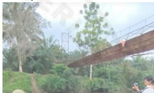
Gambar 5. Jembatan menuju sekolah mitra yang rusak
