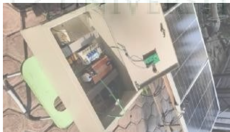
Gambar 7. Instalasi Komponen dan Modul Panel Surya
