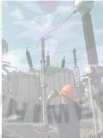
Gambar 2. Pengukuran Suhu Tangki Konservator Transformator
