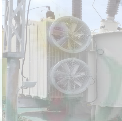
Gambar 2.7 Kipas Trafo Daya 3 Gardu Induk Sei Rotan
