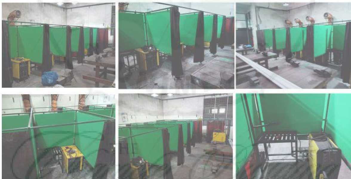
Gambar 5.2 Ruangan pengelasan sebanyak 16 unit yang sudah direnovasi secara total meliputi instalasi listrik, faktor keamanan, clemp, mesin las SMAW
