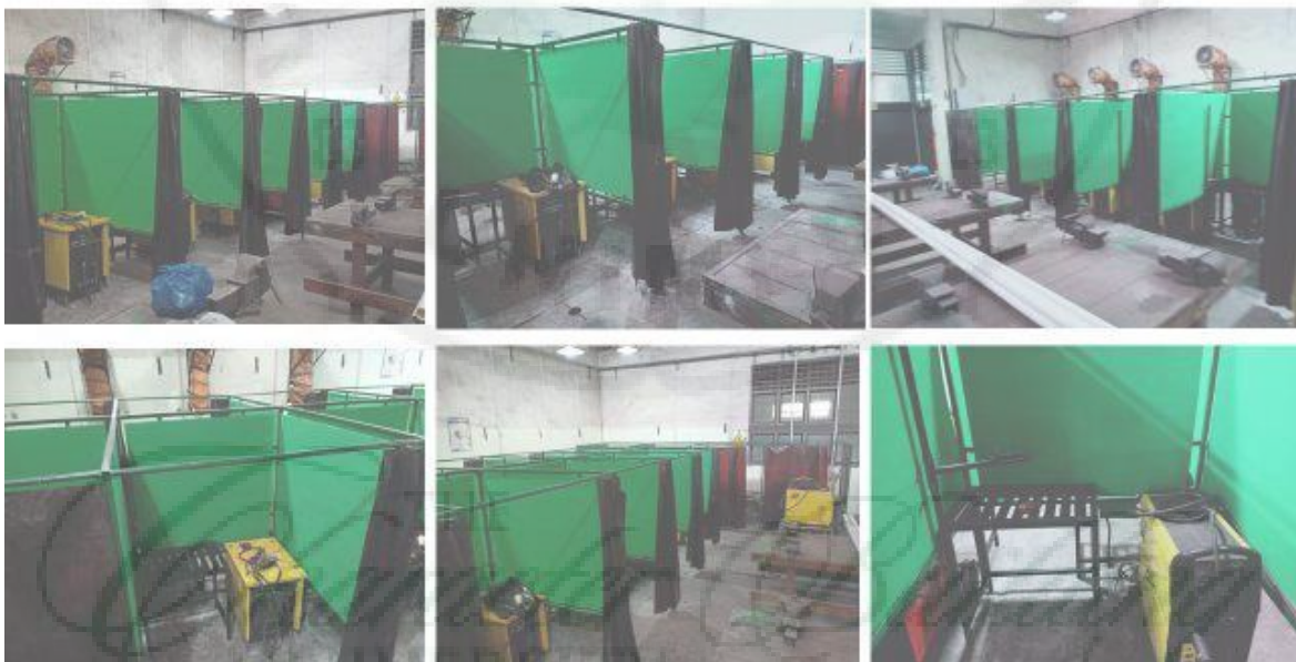
Gambar 4.2 Ruangan pengelasan sebanyak 16 unit yang sudah direnovasi secara total meliputi instalasi listrik, faktor keamanan, clemp, mesin las SMAW kapasitas 250 Ampere untuk pengelasan standar industri
